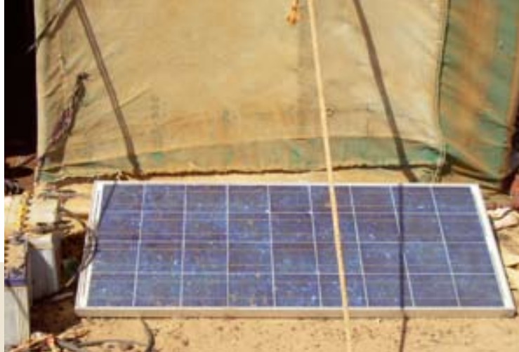
Una placa solar instalada a la entrada de una jaima
